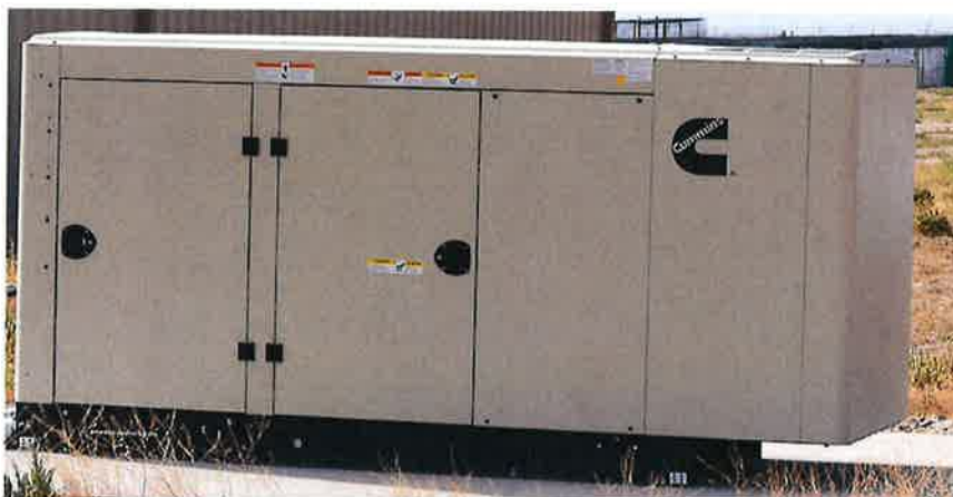
Cummins 50 KVA 200-amp generator
